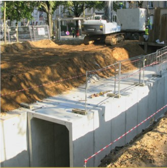
Figure : Bassins de rétention enterrée
