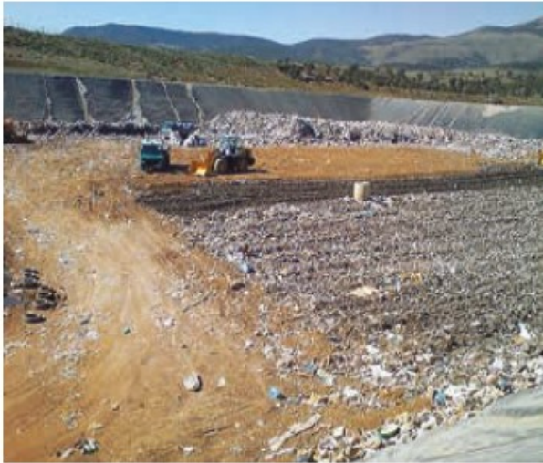
Figure 7 : CET en exploitation à Tébessa
