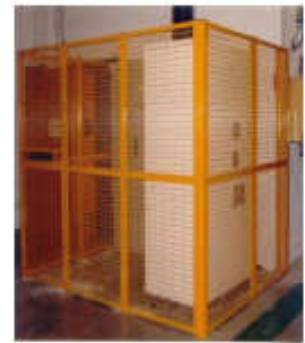
Figure V.5 : Utilisation d'obstacle : grillage (protection collective)
