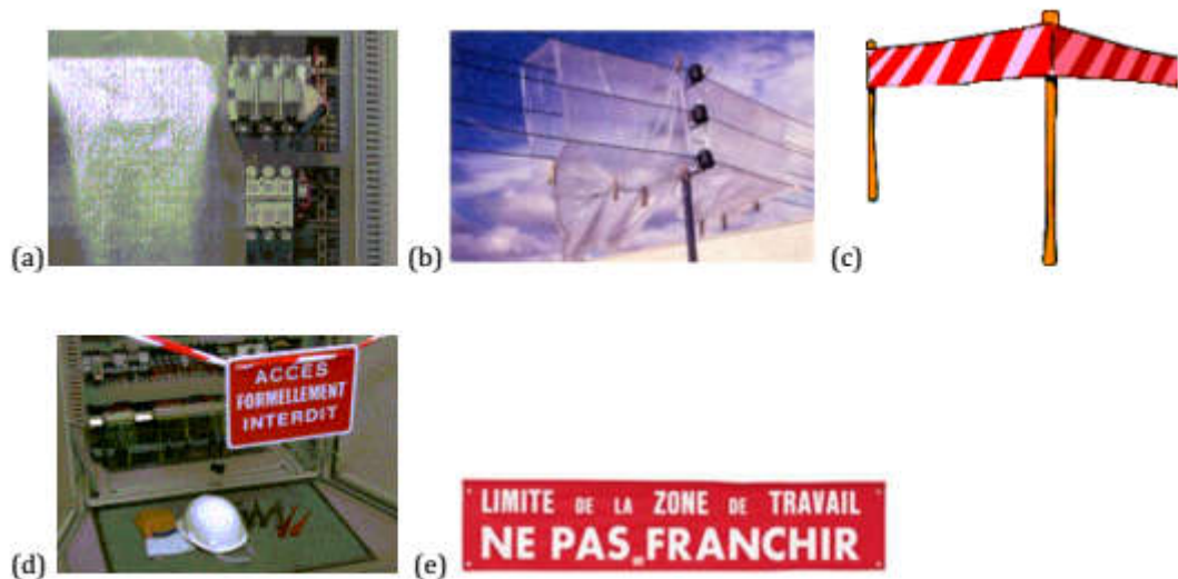
Figure III.30 : protections temporaires par écran(a), nappes, capuchons et pinces (b), balisage (c), (d) et signalisation (d) et (e)
