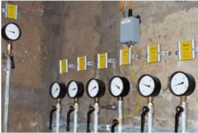
Figure 3.06-8: Mesure de la sous-pression au moyen d'un système fermés avec des points de mesure répartis d'amont vers l'aval. La valeur de la pression du 3 e manomètre depuis la droite est transmise à distance
