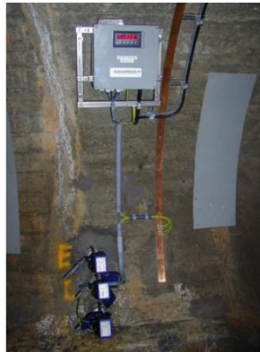
Figure 3.06-9: Système fermé avec capteurs électriques de pression avec transmission à distance placés en tête de forage pour éviter des pertes de pression
