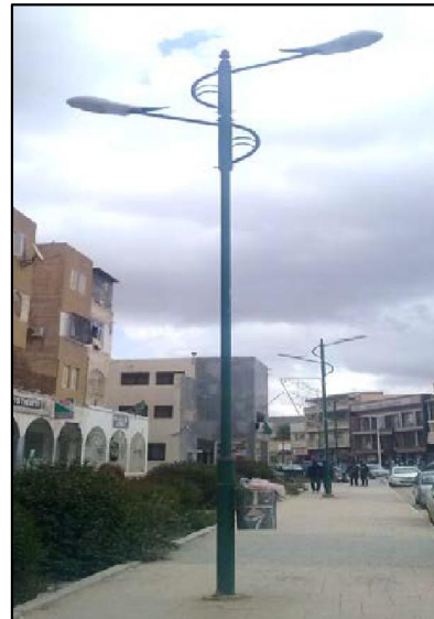
الصورة 61: أعمدة انارة وظيفية
