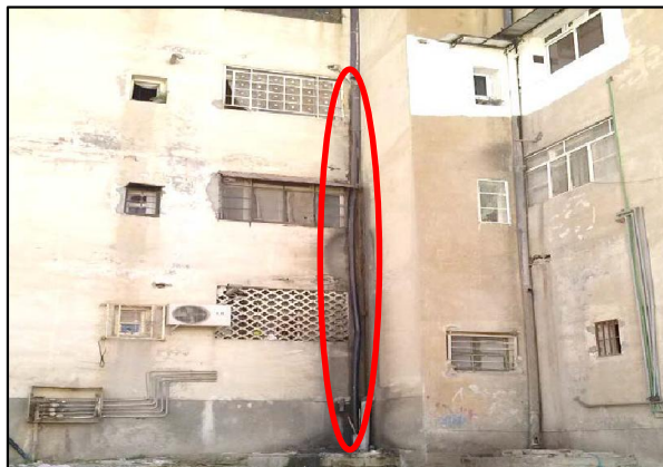
صورة 52 : حالة أنابيب الصرف الصحي الخاصة بالسكنات
